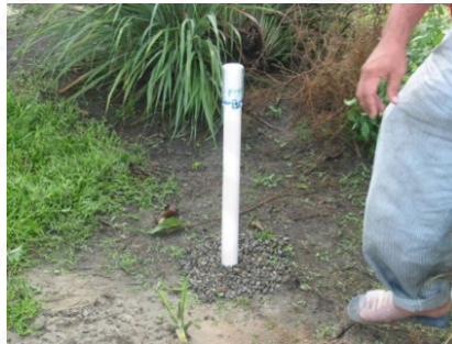
Figura 3. Pozo de observación
