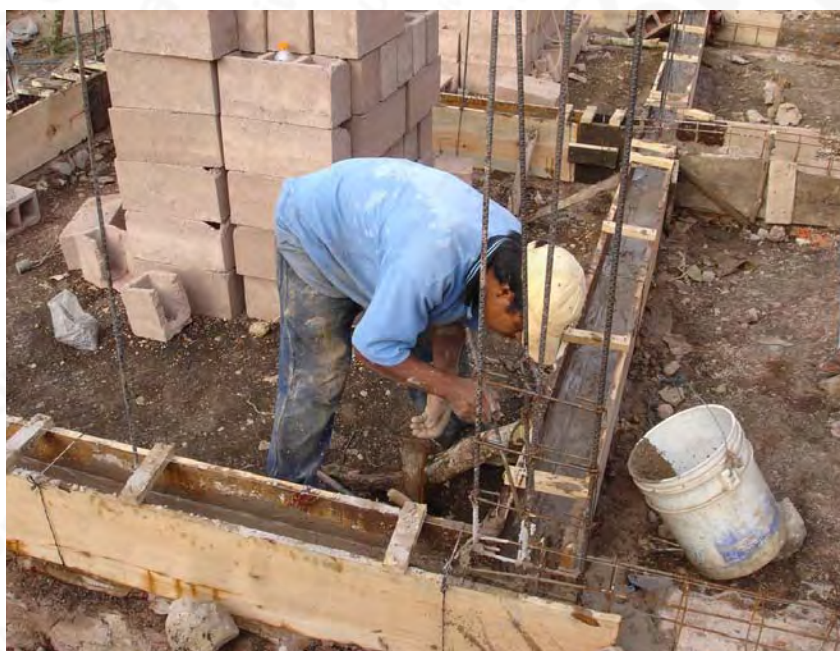
Picado de concreto en cadena de desplante
